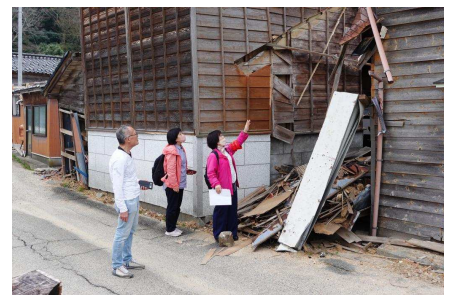
↑倒壊家屋を前にて、撤去するのも大変です。全壊のお家の方はどこにおられるのか・・・。 ←右手前の家は新しく被害はほとんどなかったのに、奥の家が傾き、家屋がずれて寄りかかってきており、屋根の一部が損壊してしまっている。
