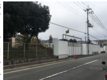
た く さ ん の 木 々 が 伐 採 さ れ 、 北 消 防 署 建 設 が 進 め ら れ て い る
